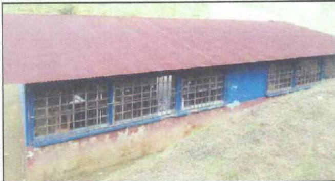
Las paredes que necesitan ser pintadas.
